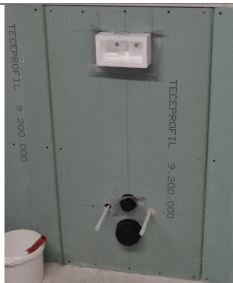
2. Frontplaten, hvor hullene på forhånd er skåret ut, monteres – se påfølgende bilder.
